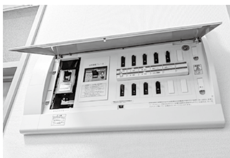
停電復旧後の通電火災を防ぐため感震ブレーカーの設置を
