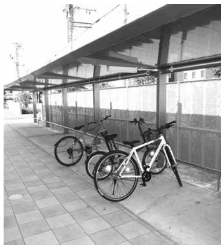
ひび割れが発生した駐輪場
